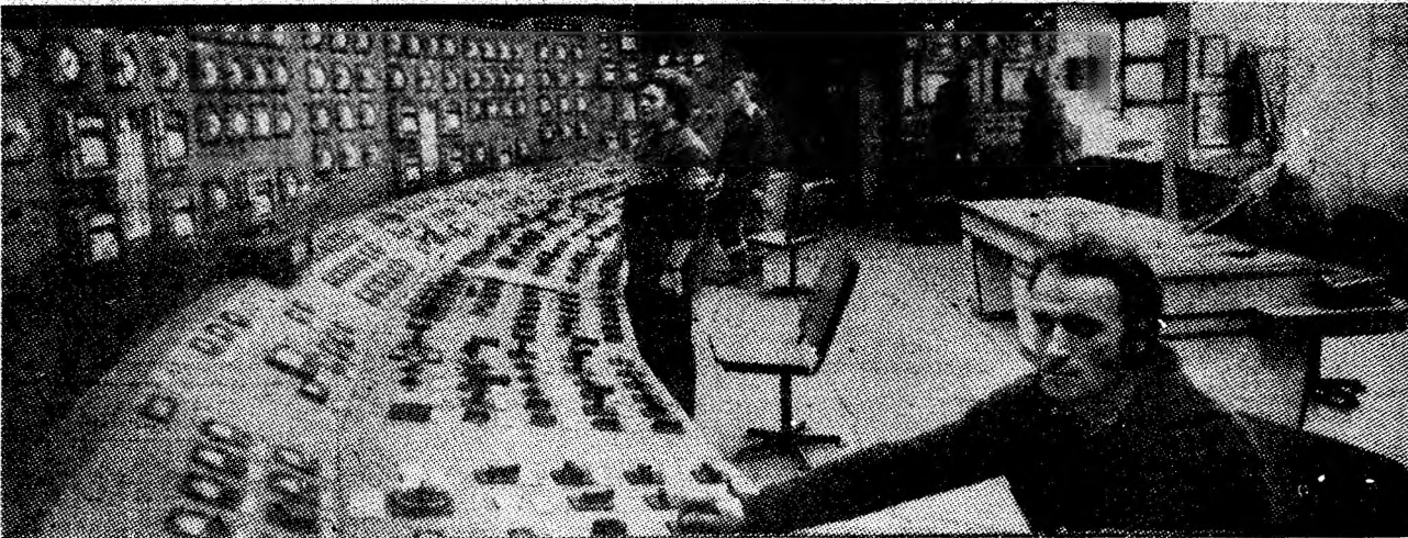
Camera de comandă termică de la UE Poroșeni. La posturi — energeticienii conduși de șeful de tură, maestrul Vasile Donciu.
