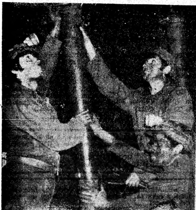
Se ridică stâlpii hidraulici în frontul abatajului brigăzii conduse de Ștefan Alba, de la I.M. Petrila. Foto: Ovidiu PĂRĂIANU
