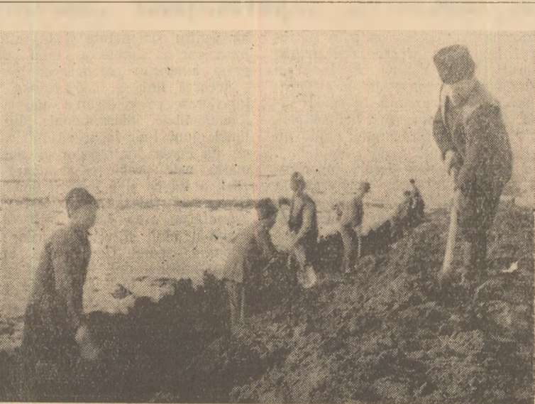
ÎN CLIȘEU: Un grup de colectivști din Cistei lucrează la amenajarea canalului principal, în vederea irigației grădini de legume.
