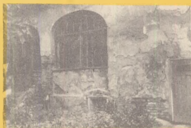
Ce vezi în poză, e numai fațada unui apartament. Dar cum e fațada
