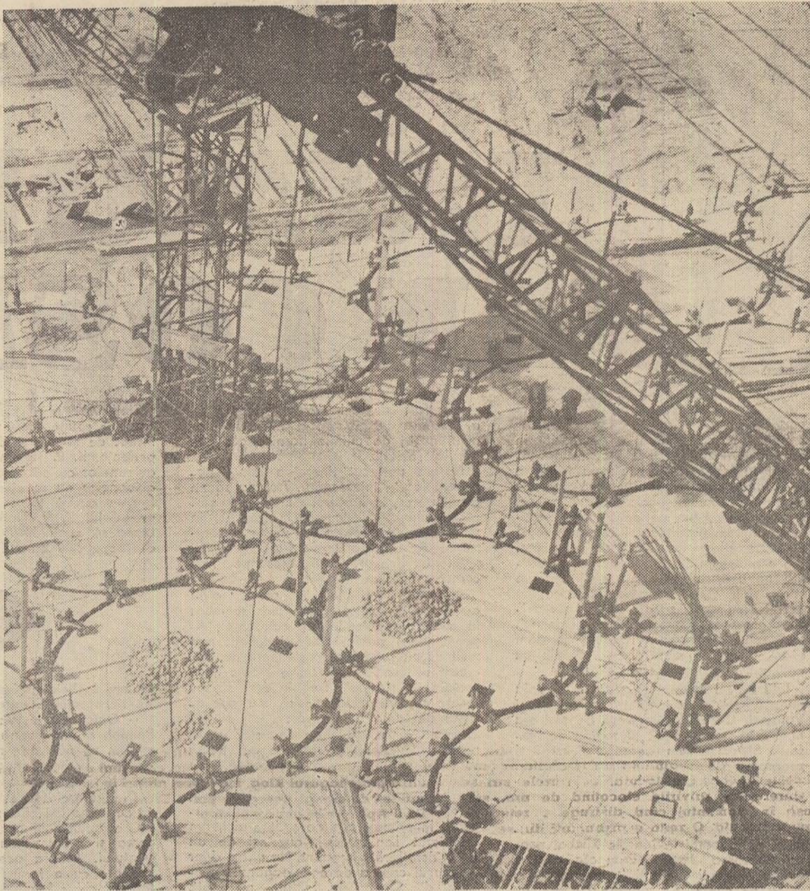
Ținutul Țelinii. Construcția elevatorului de la centrul de transbordare din Kustanai se desfășoară cu succes.
