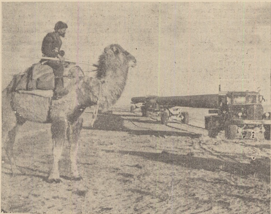
Trecut și prezent pe stepele Uzbekistanului. Se instalează țevile conductelor de gaz Gazli-Ural.
