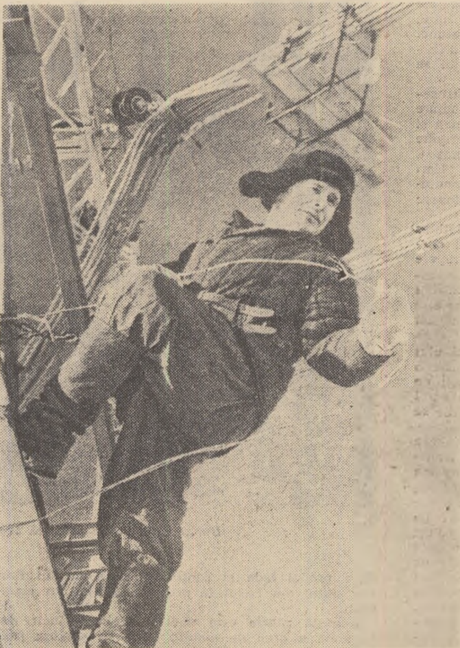
Pe șantierul centralei electrice atomice „I. V. Kurceatov” din Beloiarsk (regiunea Sverdlovsk).
