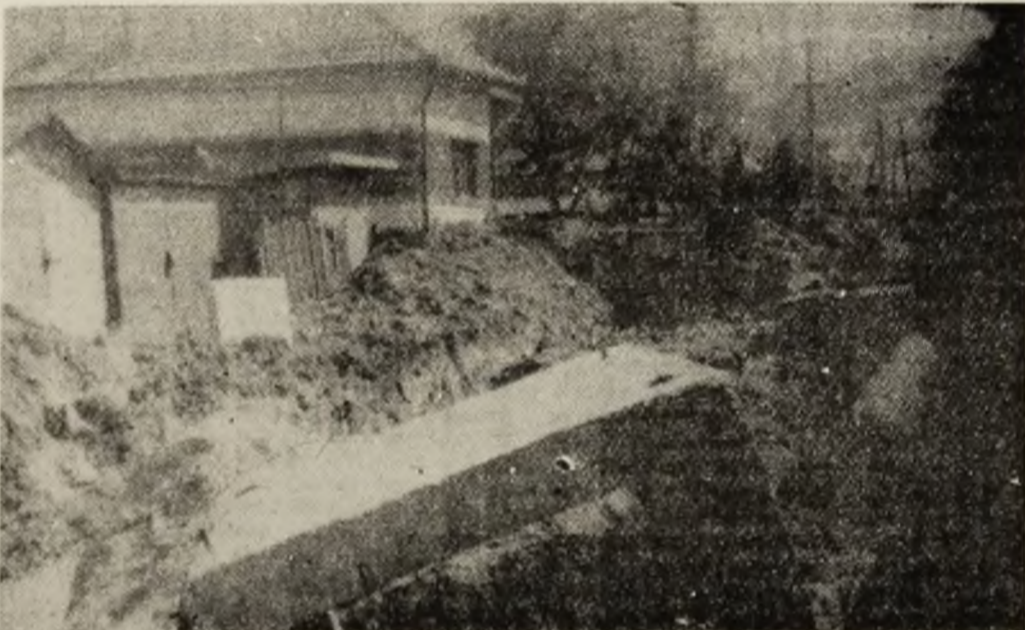
Unde nu se muncește corect, nu este în primul rînd organizarea. Aspect de pe santierul din str. P. Major — Petrosani. Foto: Sorin OPREA
